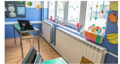
Систем за греење за училиште - Неготино Sistem ngrohjeje për shkollë - Negotinë Heating system for a school - Negotino
